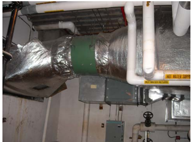
RAF-3 – Auditorium Return air fan
