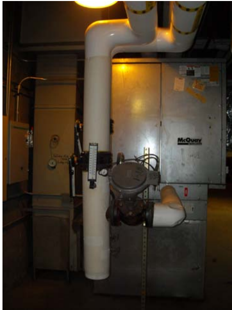
HV-1 - Upper Gym H&V Unit
